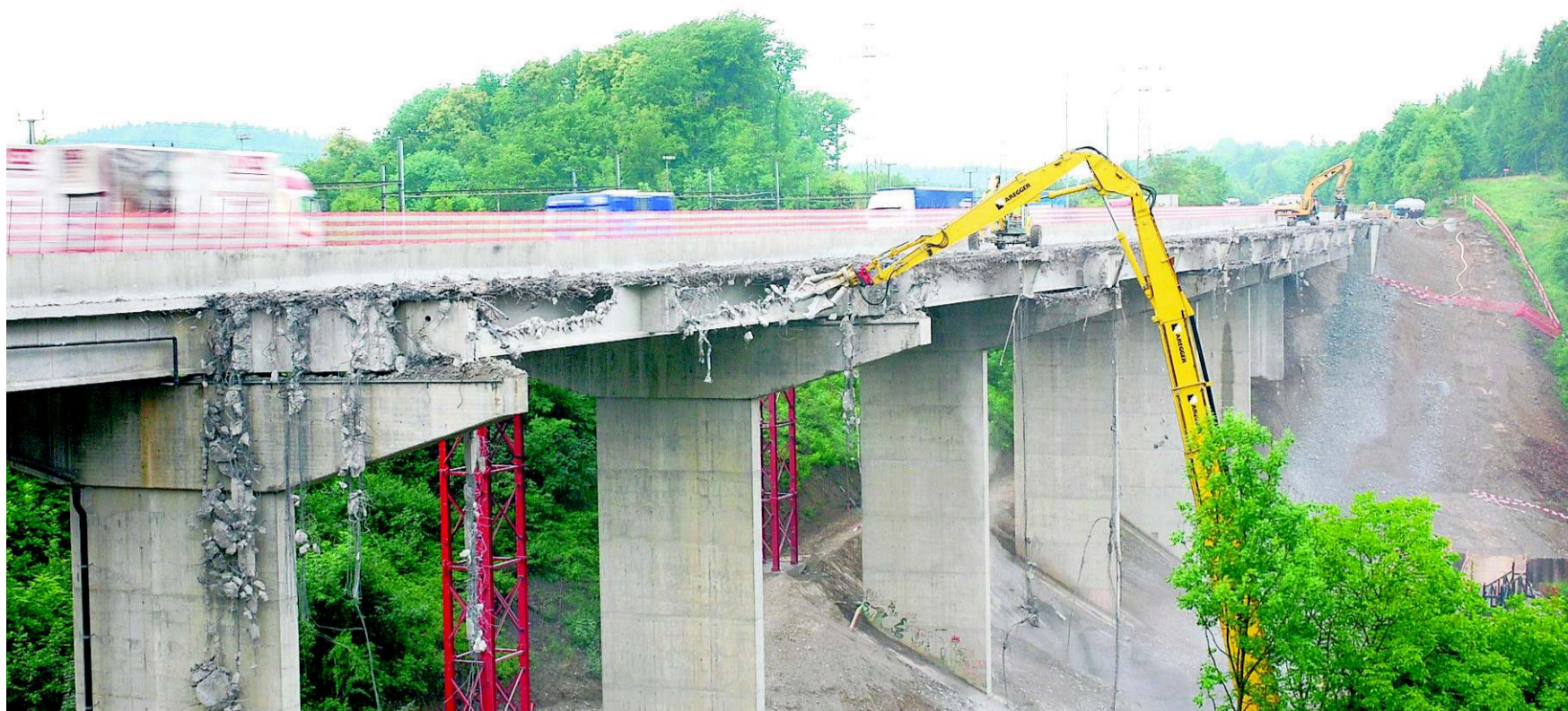
Auf der südlichen Brückenhälfte rollt der Verkehr, auf dem nördlichen Teil sind die kräftigen Betonbeisser am Werk.
