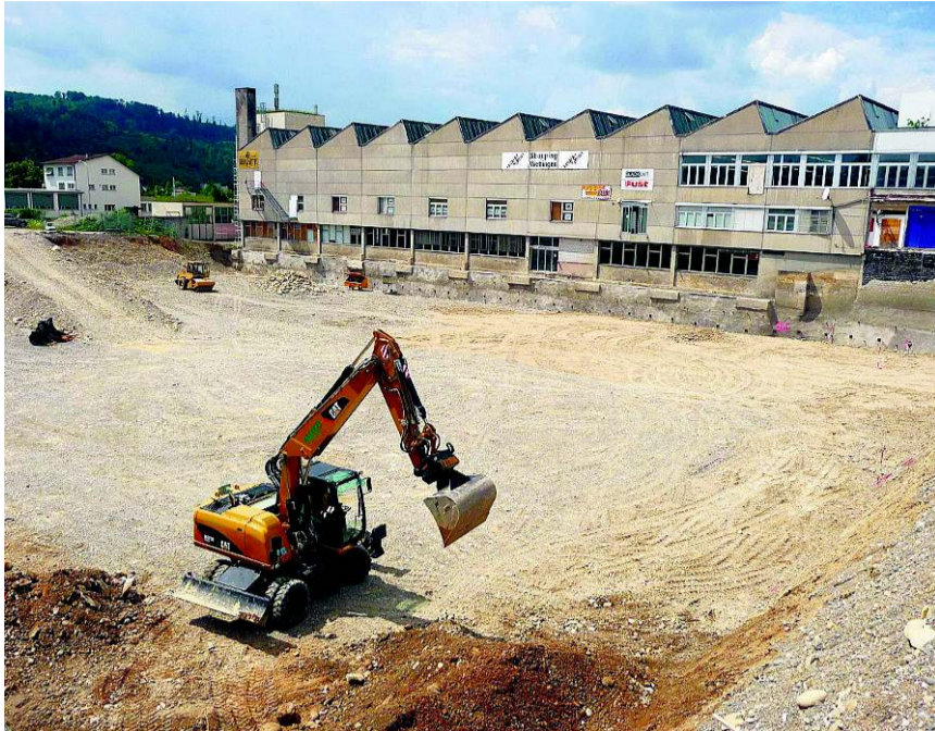
Nach einem Jahr Stillstand beendet ein Bagger den Aushub. Im Hintergrund die Shedhalle, die in zwei Monaten abgebrochen wird. MARTIN RUPF
