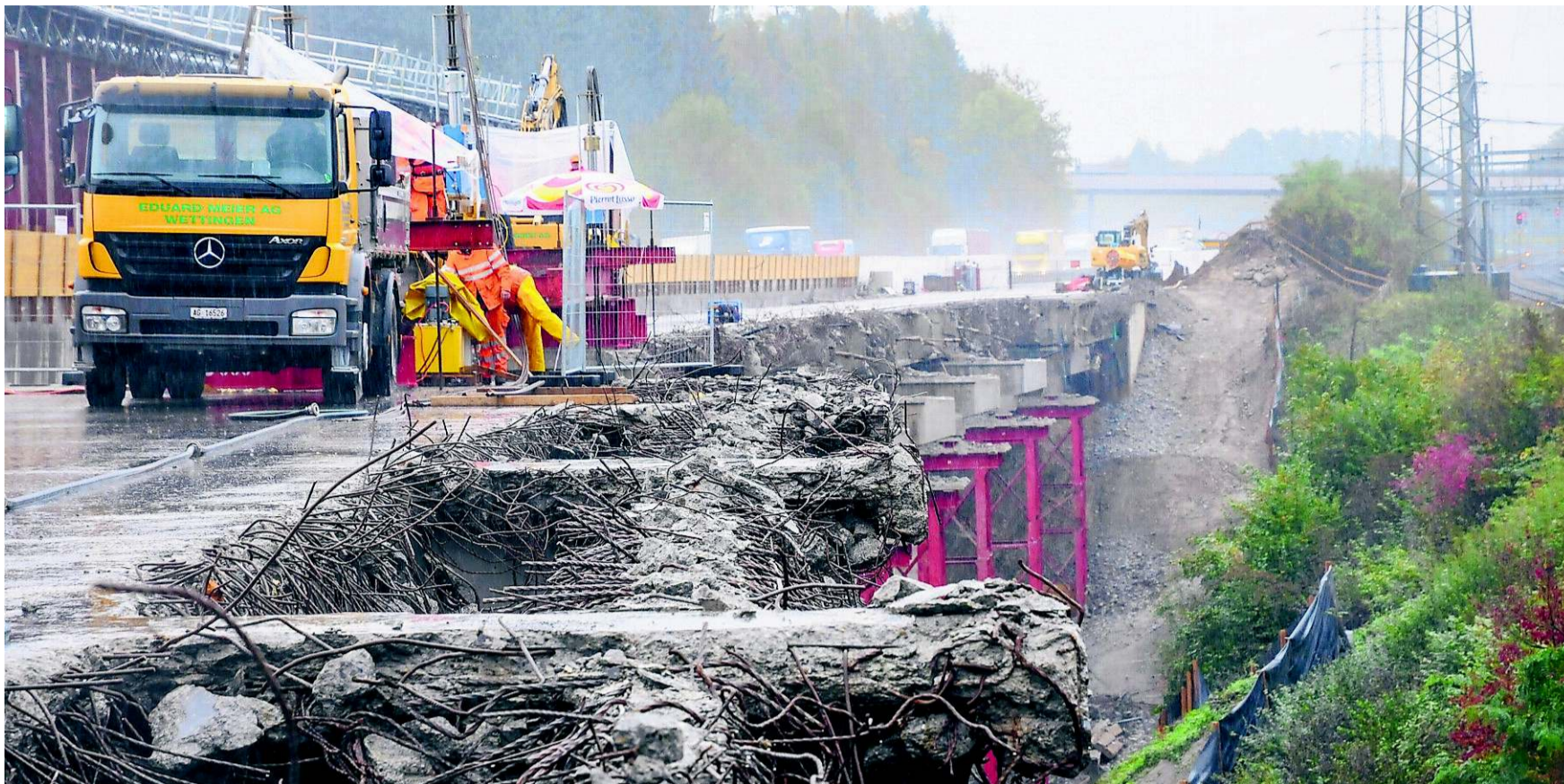
Bis Ende Oktober ist auch der zweite Teil des Bünzthal-Viadukts abgerissen, dann beginnt der Neubau der zweiten Zwillingsbrücke. TONI WIDMER
