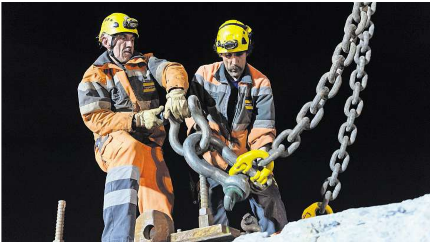
Zwei Arbeiter bringen schwere Ketten an, damit die Brückenaufhängungen entfernt werden können.
